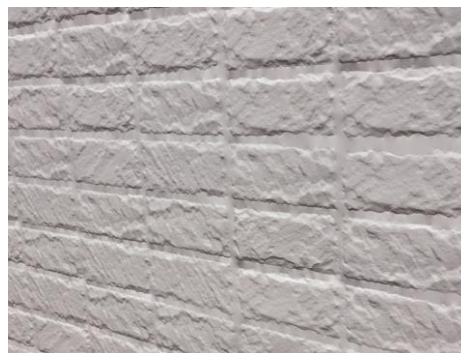
目地部分施工の悪い例
