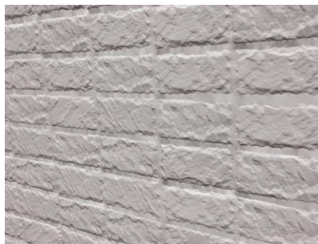
目地部分施工の悪い例
